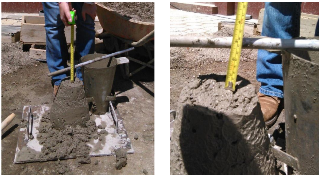
Figura 9. Escuela primaria aldea Chanchán, medición de asentamiento
