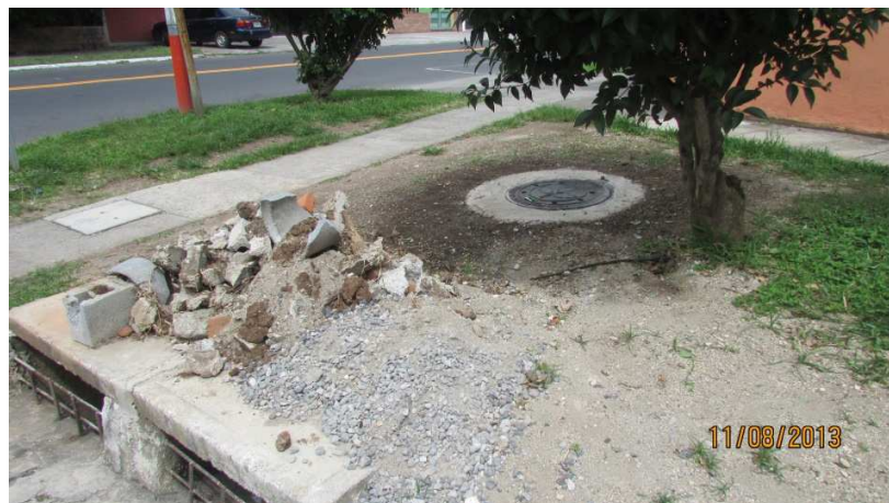
Figura 36. Tapadera pozo de absorción
