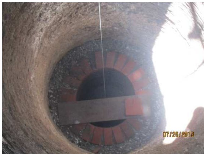
Figura 25. pozo de absorción
