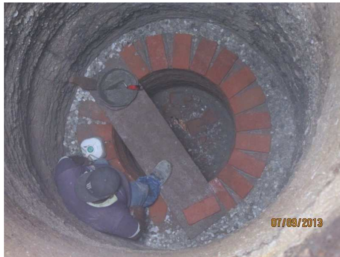
Figura 33. Piedrín entre pared y ladrillo
