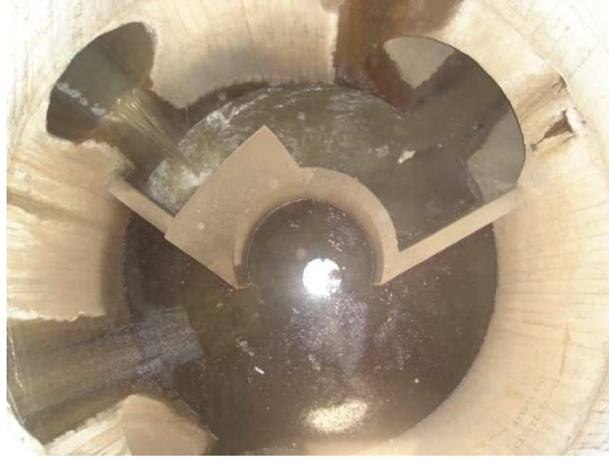
Figura 6. Foto derivador de caudal
