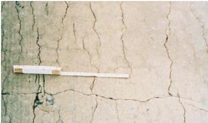
Figura 7. Fisuración del concreto debido a la reacción álcali-agregado
