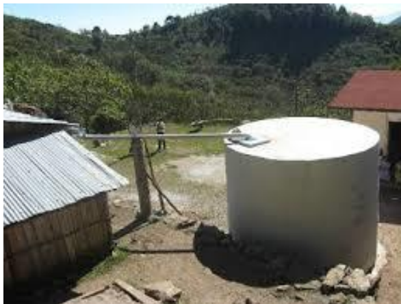
Figura 3. Tanque de almacenamiento de agua hecho de ferrocemento
