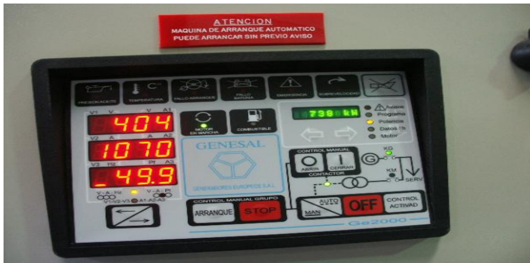
Figura 11. Cuadro de arranque automático
