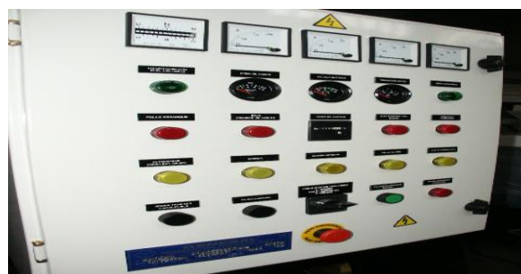
Figura 10. Cuadro eléctrico de control
