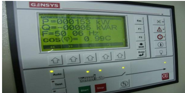
Figura 12. Cuadro de arranque eléctrico
