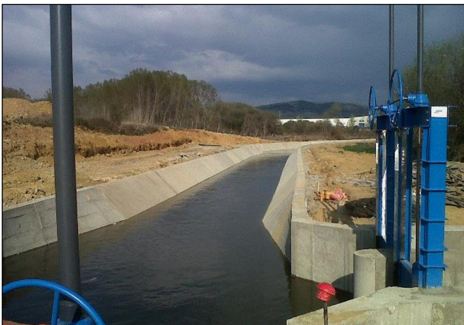
Figura 1. Canal en expansión
