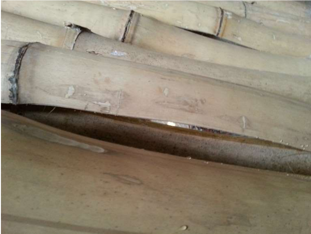
Figura 30. Filtración por abertura entre cañas de bambú
