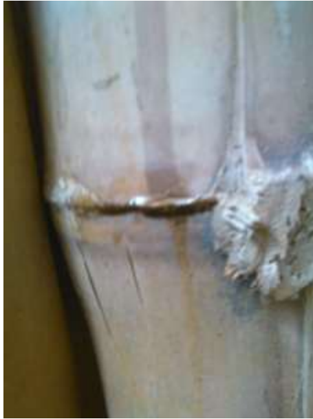
Figura 28. Filtración por rajadura en nudo
