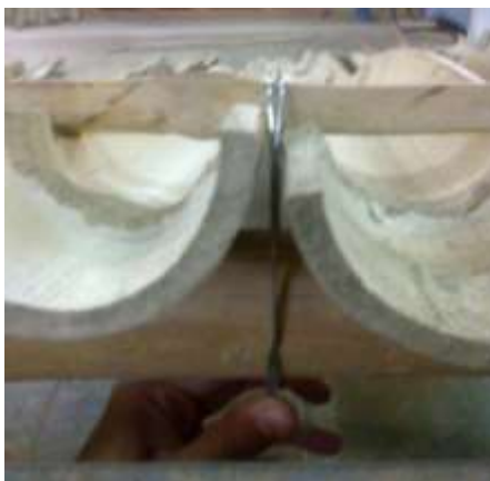
Figura 53. Sujeción de pasador y estructura de soporte de cubierta de techo con alambre galvanizado
