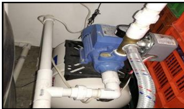
Figura 11. Bomba para distribuir agua al sistema de filtrado
