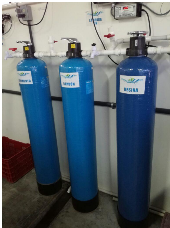
Figura 18. Filtros de resina, carbón y sedimento
