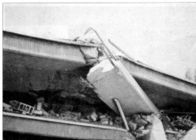
Figura 25. Falla por escasez de anclaje del refuerzo de la columna en su conexión con la columna
