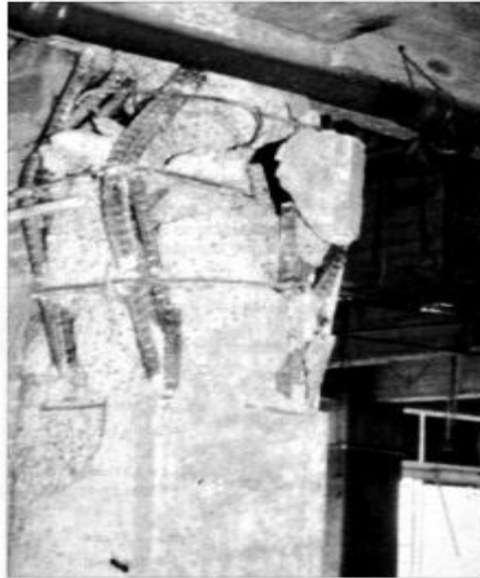
Figura 24. Falla de columna con escaso refuerzo transversal
