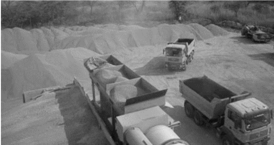
Figura 34. Tolvas del sistema dosificador de agregados
