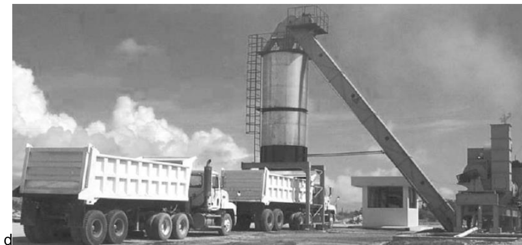
Figura 37. Conjunto de transportador escalonado y silo de almacenamiento
