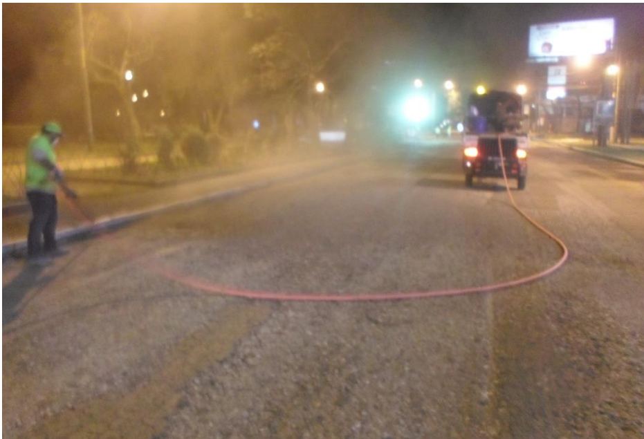
Figura 49. Compresor de aire para limpieza
