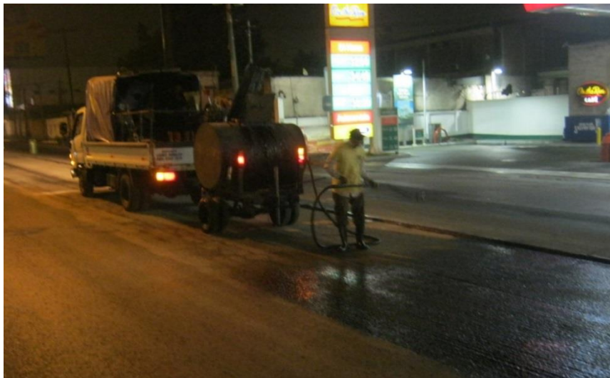
Figura 51. Tanque distribuidor de ligante
