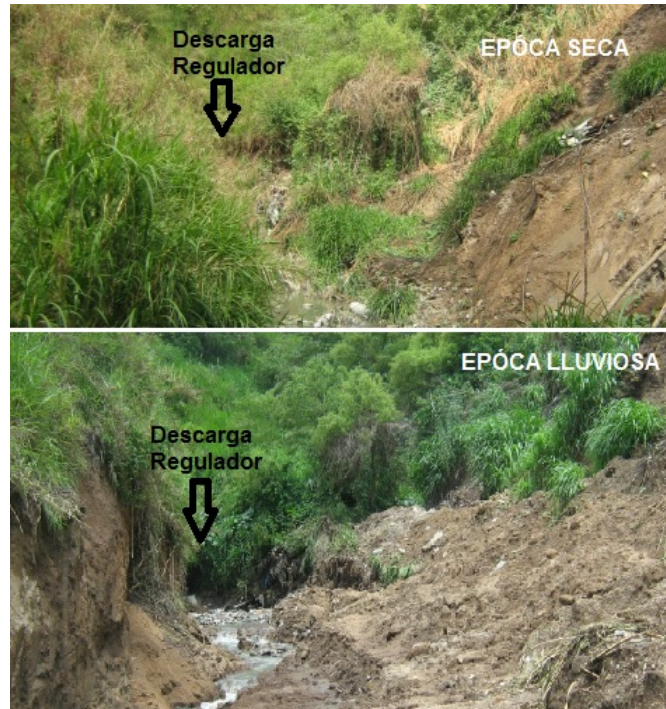
Figura 31. Fotografía Regulador de caudal, colonia Covias
