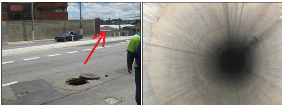
Figura 43. Regulador de caudal 27 calle final, zona 5
