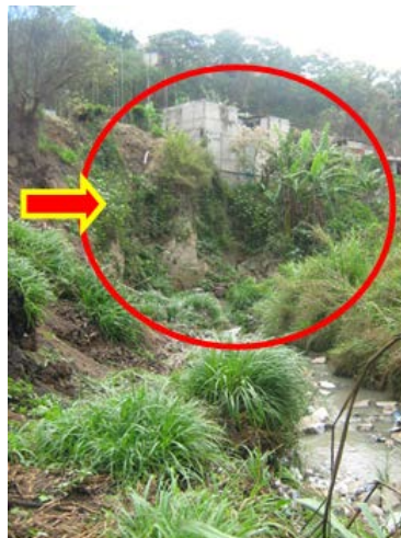
Figura 32. Talud afectado por erosión
