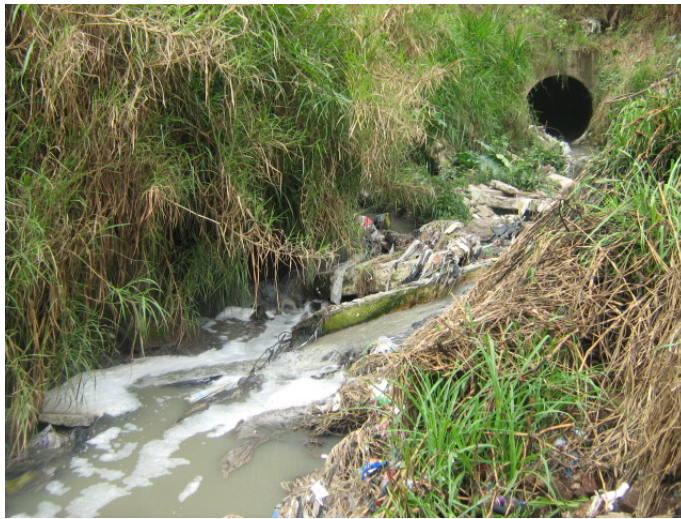
Figura 33. Contaminación descarga regulador de caudal, Covias
