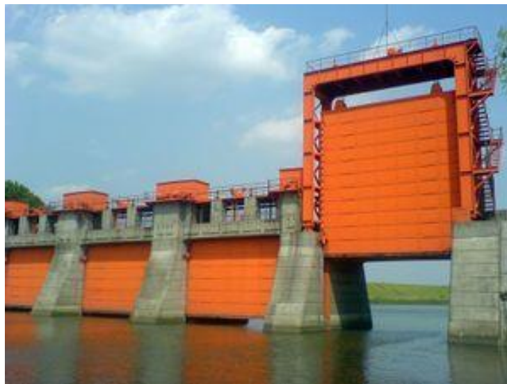
Figura 6. Vertedero controlado por compuertas hidráulicas
