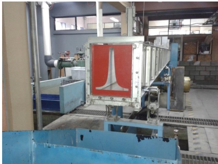
Figura 21. Vertedero instalado tomado desde un ángulo diferente
