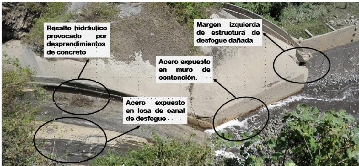
Figura 10. Daños identificados en canal de desfogue
