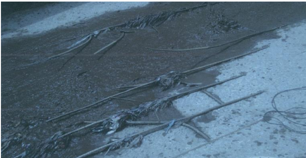
Figura 12. Refuerzo expuesto en losa del canal de desfogue
