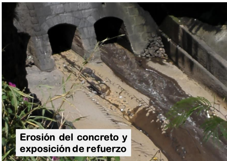
Figura 9. Estado actual del canal de desfogue
