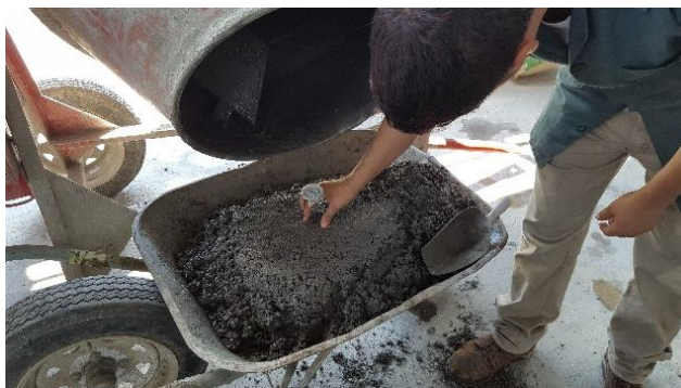
Figura 18. Ensayo de temperatura
