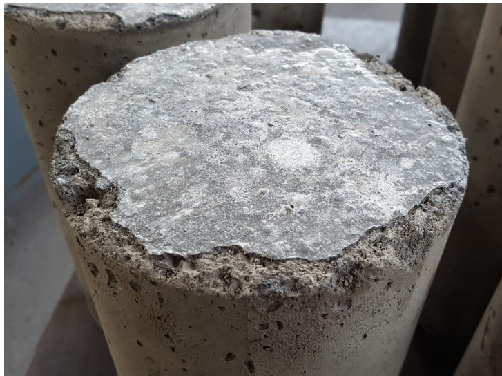
Figura 30. Carbonatación del concreto en la parte superior
