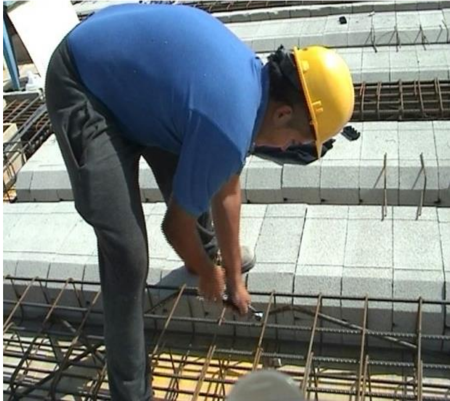
Figura 1. Actividad realizada con postura forzada, sector construcción
