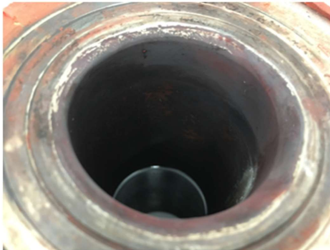
Figura 20. Rouging en tubería de generador de vapor
