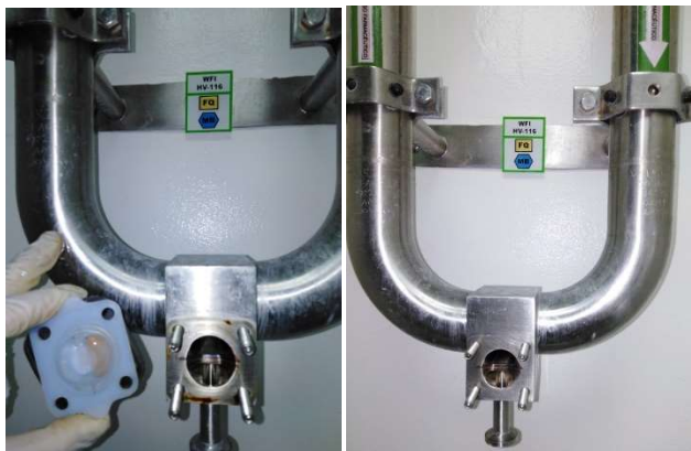
Figura 23. Cambio de diafragmas en las válvulas del sistema WFI
