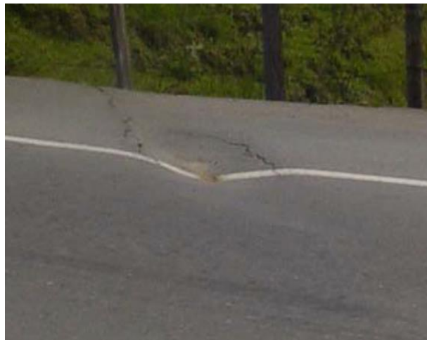
Figura 11. Hundimiento severidad alta
