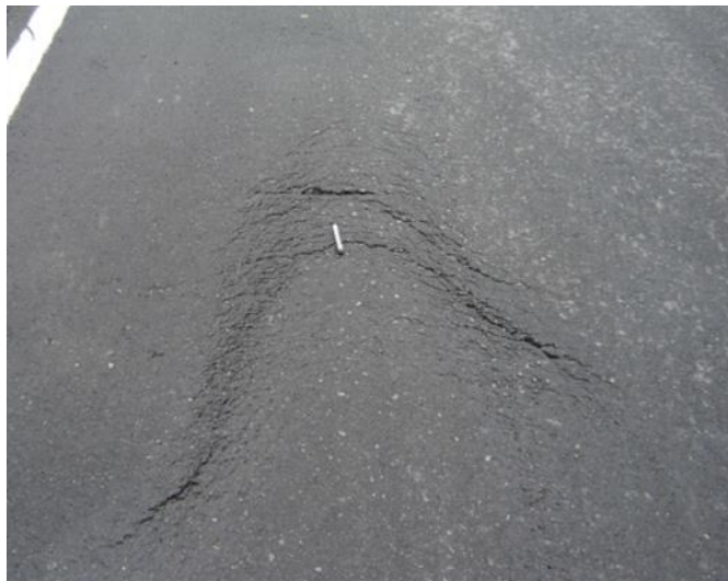
Figura 3. Fisuras en arco de severidad alta
