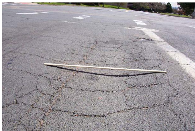
Figura 7. Ahuellamiento severidad alta
