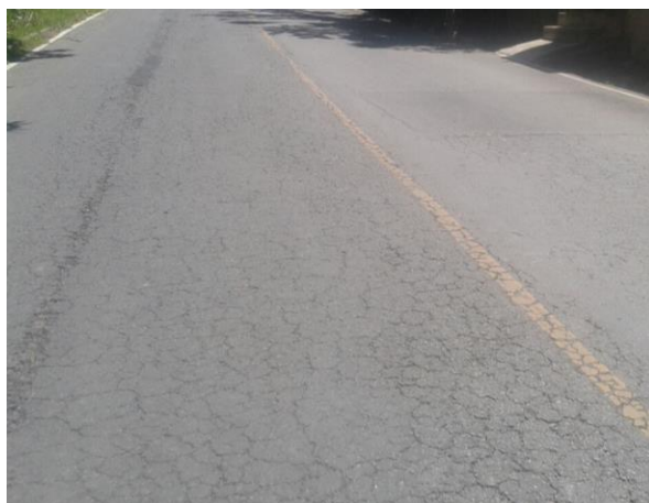
Figura 1. Piel de cocodrilo de severidad alta
