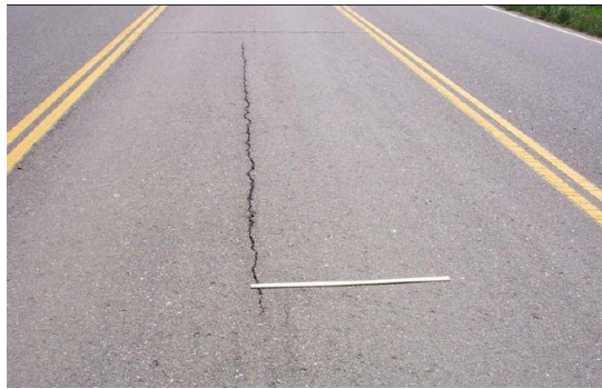
Figura 5. Fisura longitudinal severidad media
