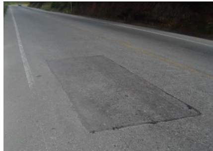
Figura 15. Parchado de severidad media
