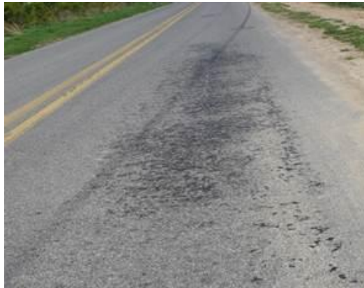
Figura 14. Exudación severidad media
