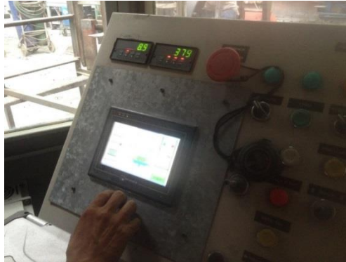
Figura 14. Tablero de controles
