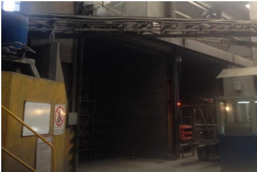
Figura 16. Túneles de curado
