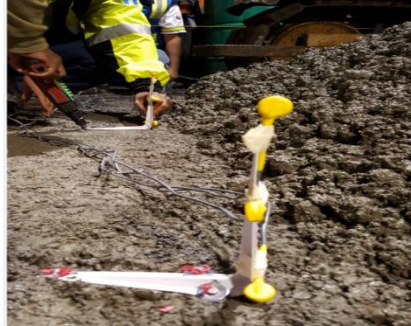
Figura 68. Sensores sujetos a la ménsula y a la base
