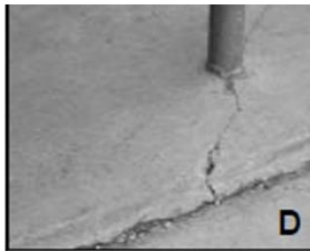
Figura 7. Grietas debidas a la falta de una junta de aislamiento
