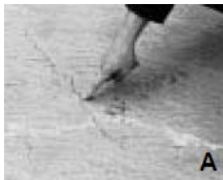
Figura 4. Grietas por contracción plástica
