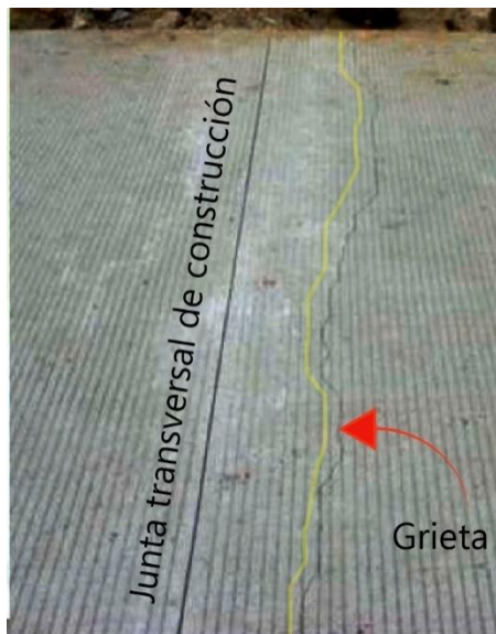
Figura 26. Grietas por barras de transmisión desalineadas
