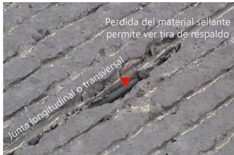
Figura 28. Pérdida de sello en juntas
