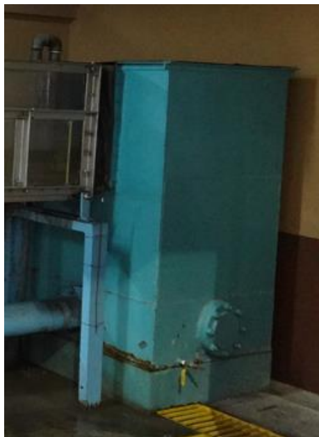
Figura 18. Tanque metálico de succión por bomba
