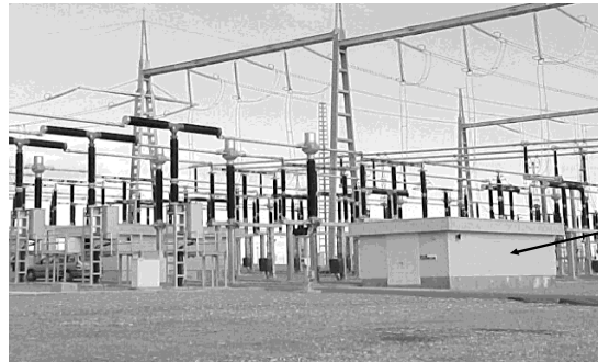
Figura 7. Ejemplo de subestación eléctrica a la intemperie
