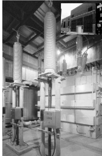
Figura 8. Ejemplo de subestación eléctrica de interior
