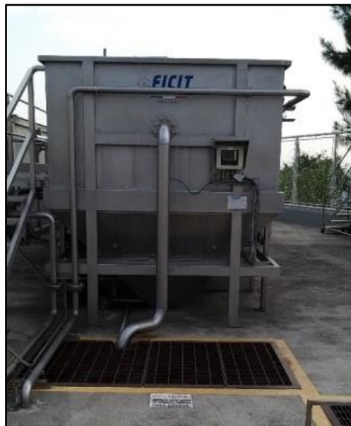
Figura 53. Planta de tratamiento de aguas residuales
