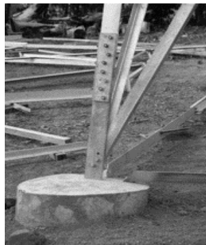
Figura 3. Cimentación para una torre de transmisión eléctrica en una de sus cuatro patas
