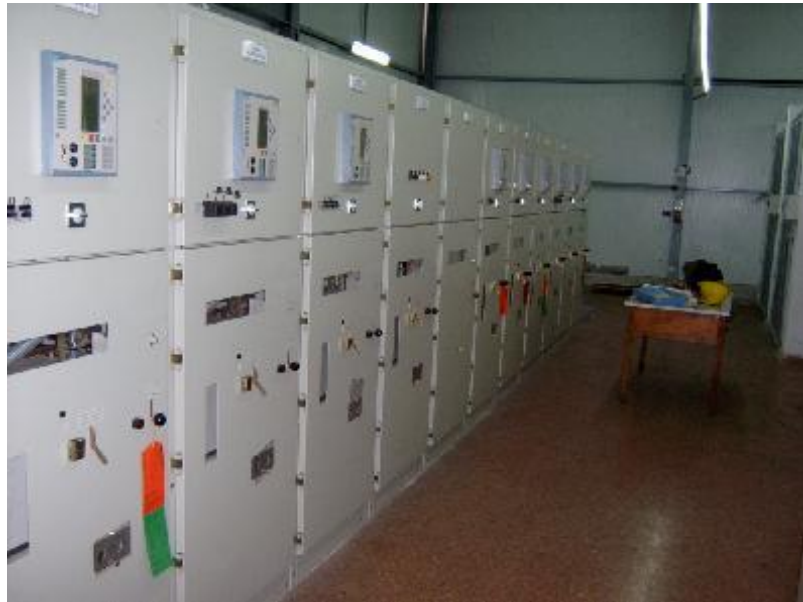
Figura 55. Equipos en caseta de control
