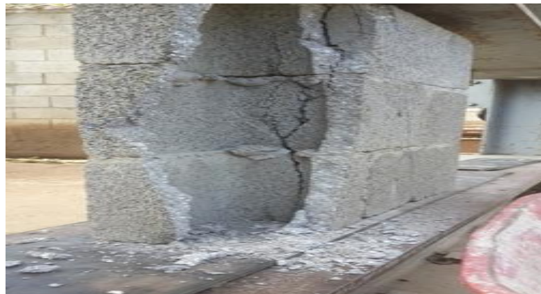
Figura 11. Falla en muro luego de ensayarla a compresión
