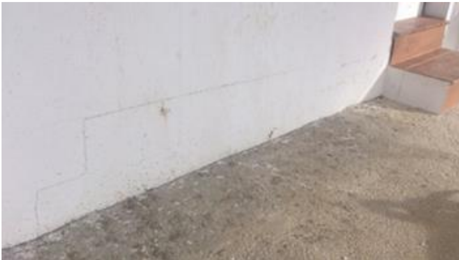
Figura 2. Falla por fisura de aplastamiento
