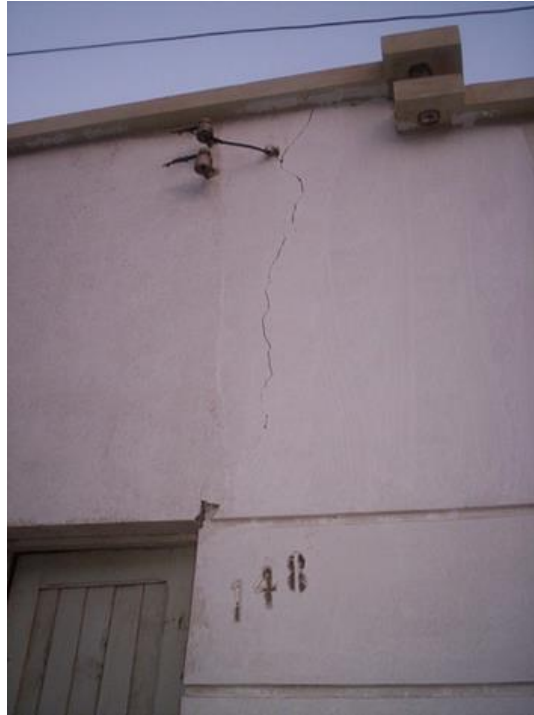
Figura 3. Falla por flexión o grieta vertical
