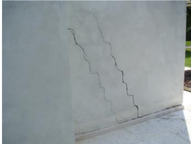
Figura 5. Falla de muro escalonada o grieta diagonal
