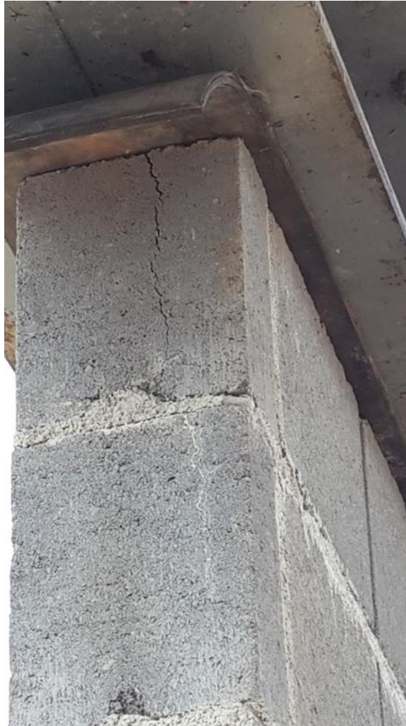
Figura 15. Grieta presentada en el muro
