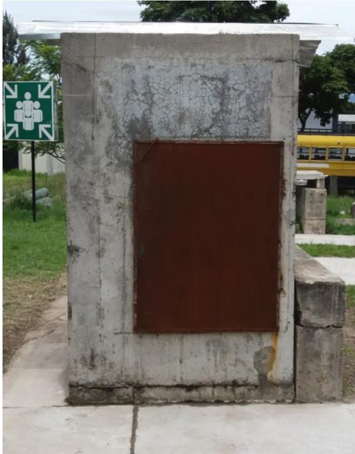
Figura 31. Horno de concreto
