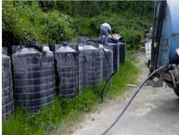
Instalaciones para el manejo de agua
