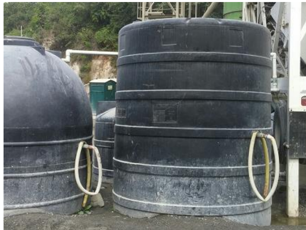
Instalaciones para el manejo de agua
