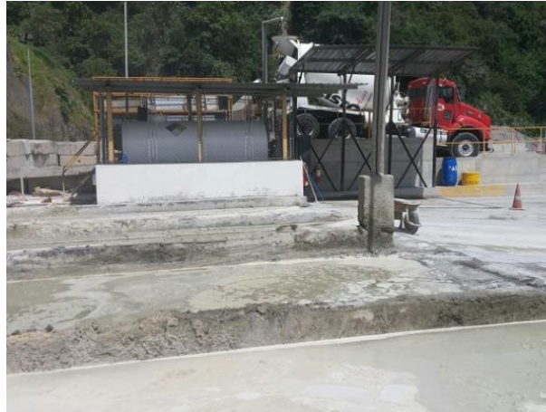
Piletas de sedimentación (área de lavado de concreto devuelto)
