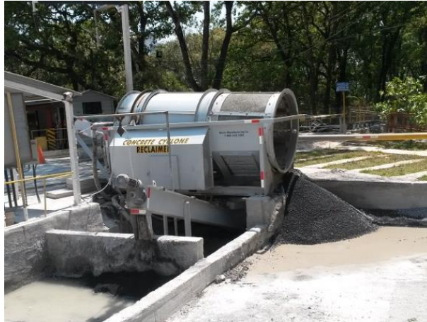
Equipo de reciclamiento de concreto residual en camiones y agua de lavado
