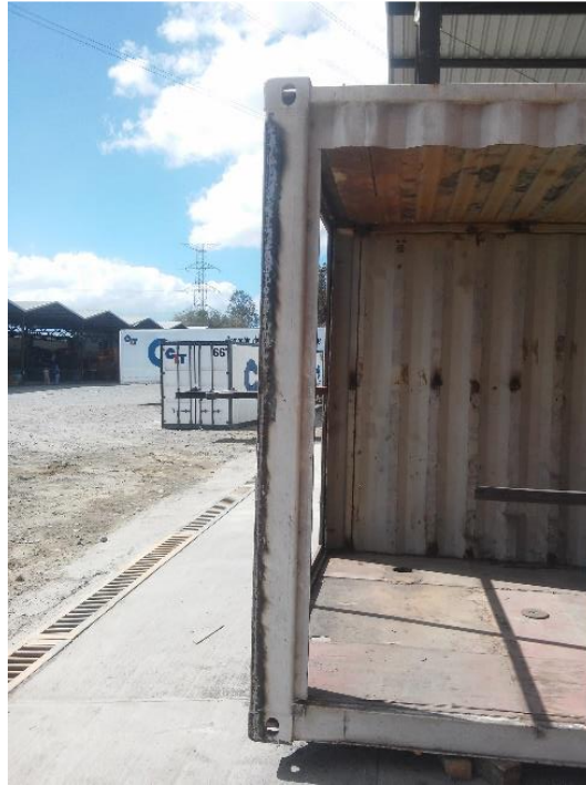
Figura 9. Poste frontal en contenedor desmantelado
