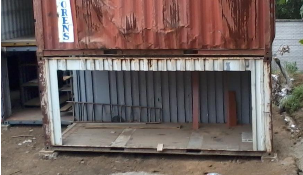
Figura 42. Contenedor sin panel lateral
