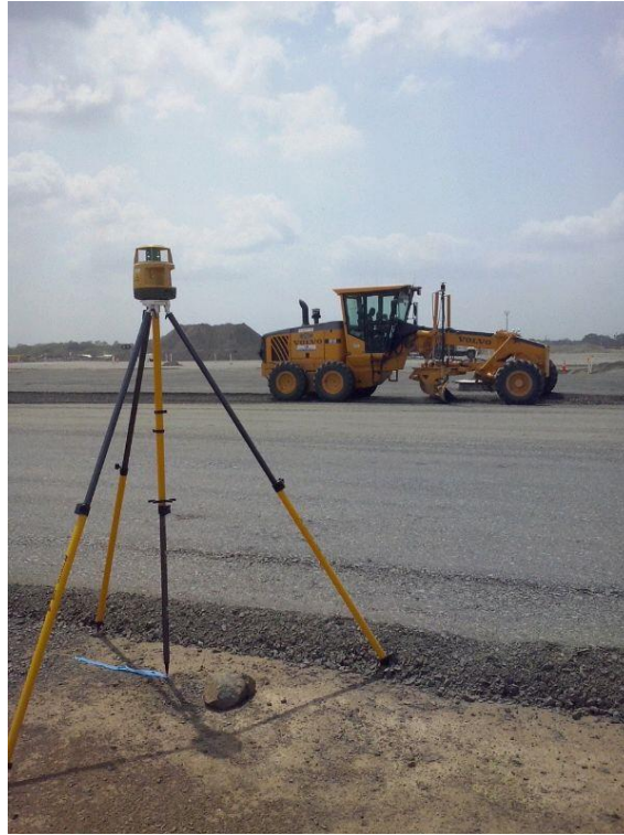
Figura 30. Transmisor milimétrico enviando señal a motoniveladora
