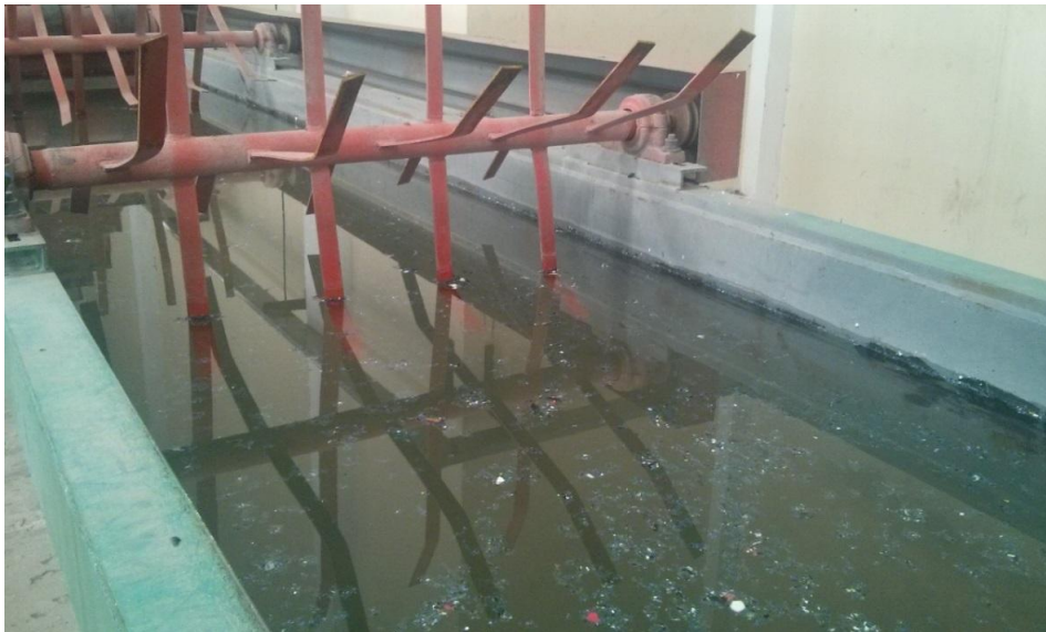
Figura 16. Maquinaria aspas lavado
