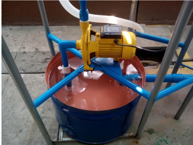
Figura 20. Equipo de bombeo y depósito de agua
