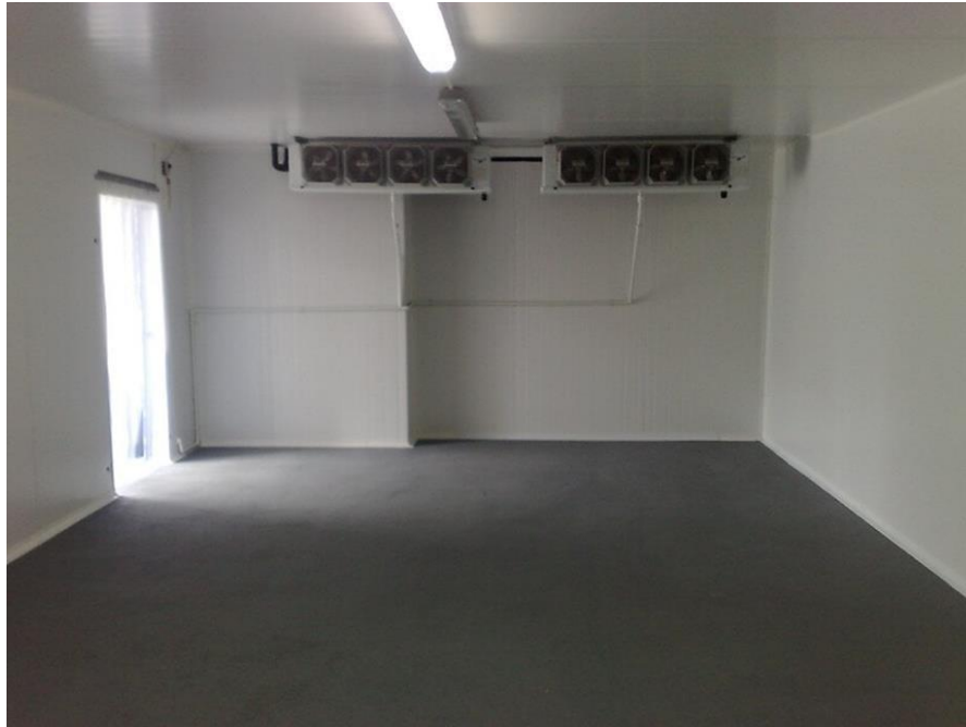
Figura 1. Vista interior de cuarto frío
