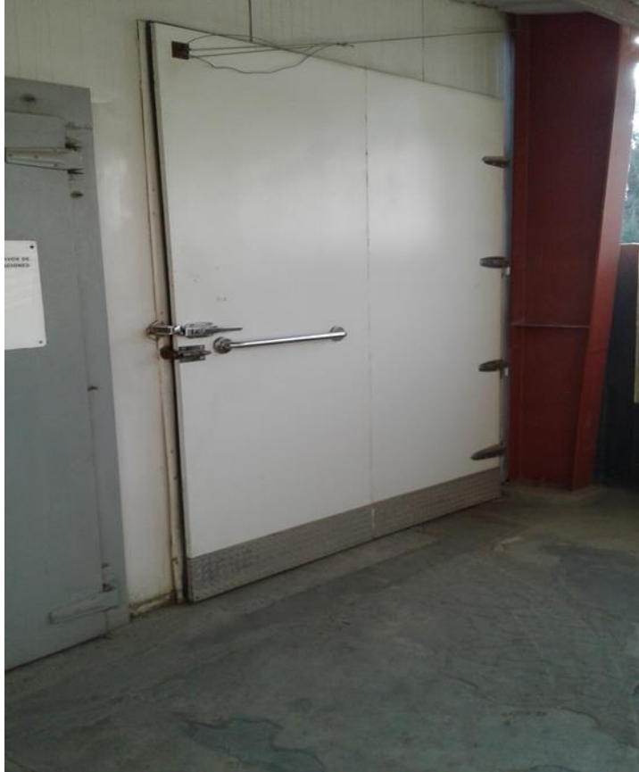
Figura 5. Puerta de cuarto frío
