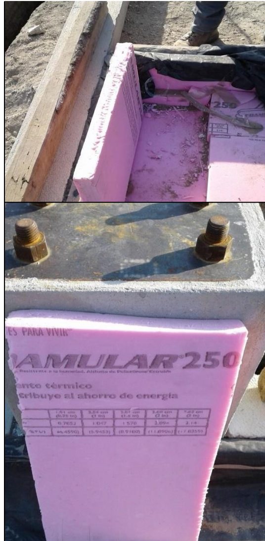
Figura 16. Uso de material aislante en pisos de cuartos fríos
