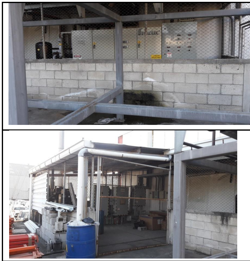
Figura 31. Vista de casetas de equipos de cuartos fríos
