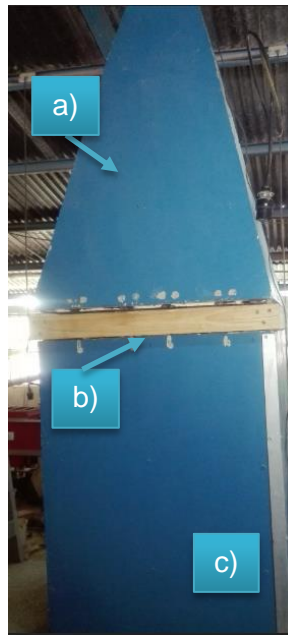
Figura 48. Equipo de aislamiento térmico
