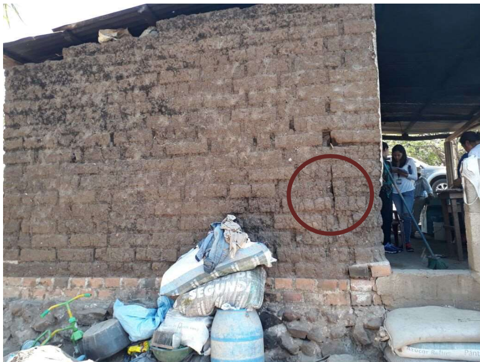
Figura 71. Muro de vivienda de adobe con daños
