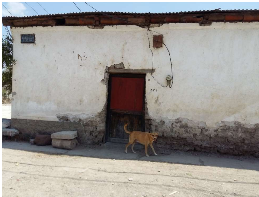
Figura 74. Muro de adobe con deterioro en el recubrimiento
