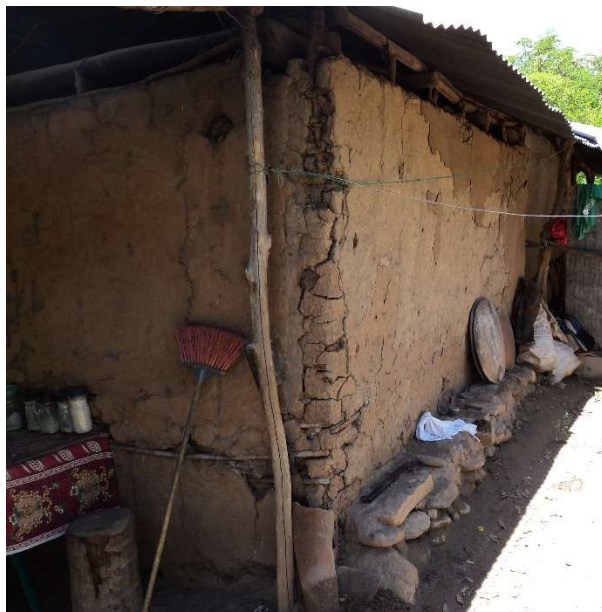
Figura 51. Esquina de vivienda con daño en esquina de muro
