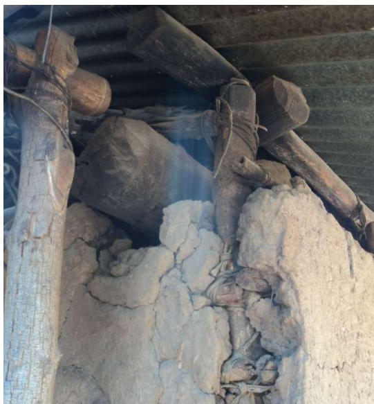
Figura 53. Estado de nudo en vivienda sin protección
