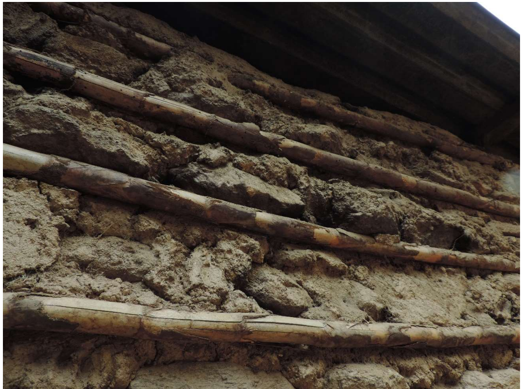
Figura 46. Varillas de refuerzo en vivienda de bajareque
