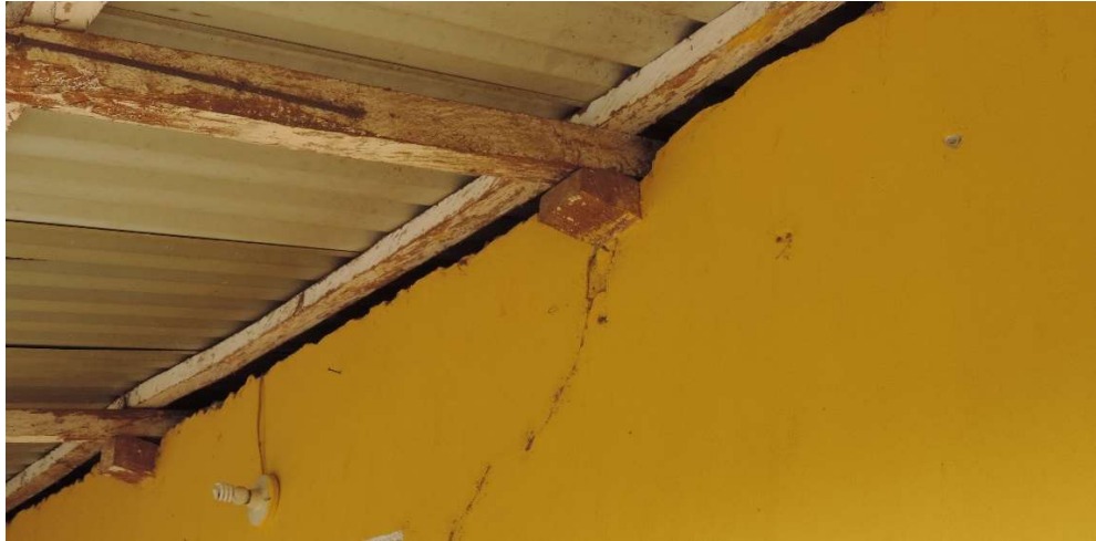
Figura 41. Deficiente amarre entre muros y estructura de techos
