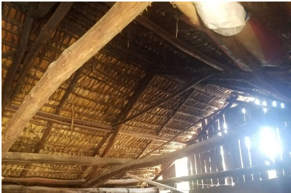
Figura 42. Estructura de techo alto y tímpano reforzado
