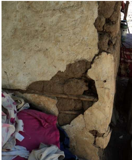
Figura 52. Estado de recubrimiento en esquina de muro
