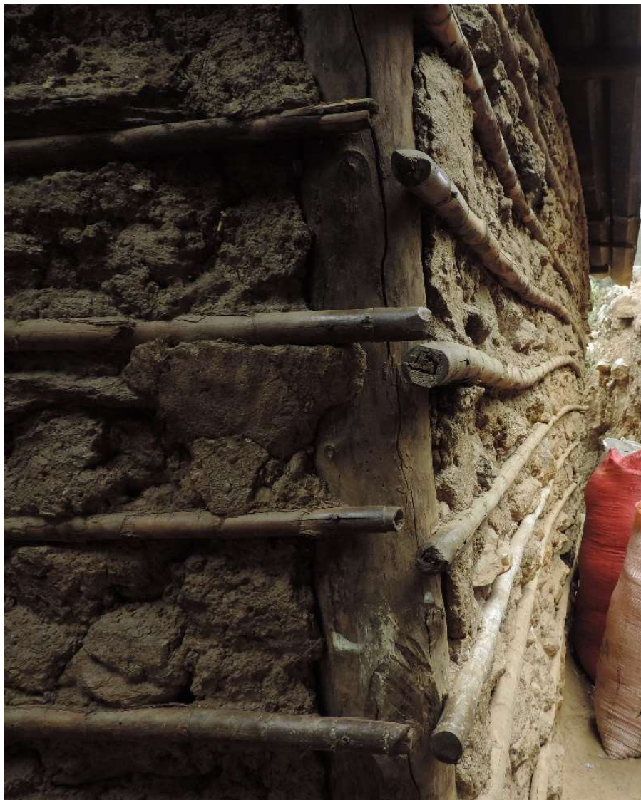
Figura 48. Traslape de refuerzos en esquina de vivienda de bajareque
