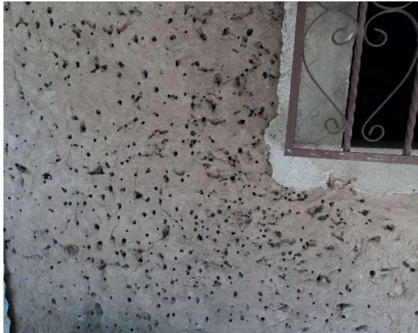
Figura 37. Vivienda de bajareque en proceso de recubrimiento con agujeros provocados por plagas
