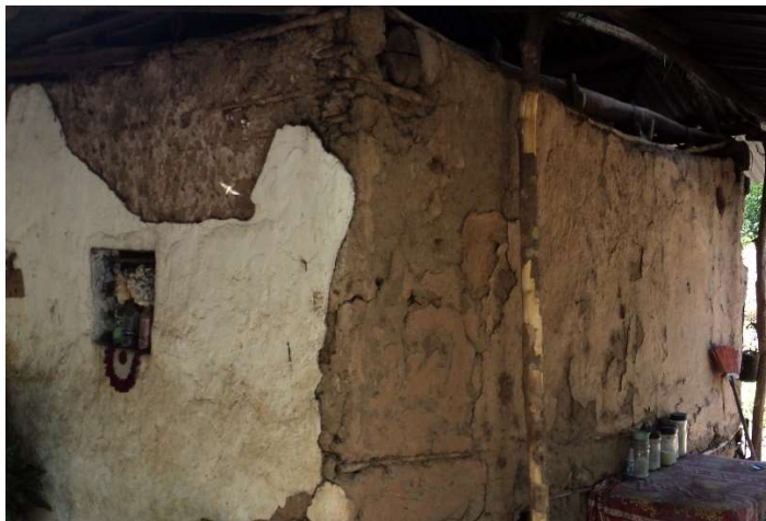
Figura 50. Muro de bajareque con mal estado de recubrimiento
