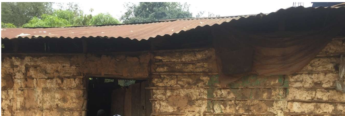
Figura 40. Uniones en encadenado techo-muro débiles
