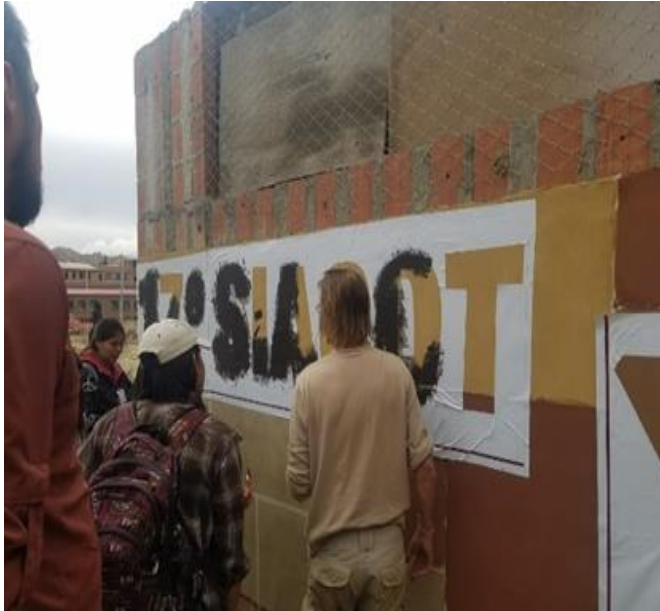
Figura 64. Muro cubierto con revestimiento y color
