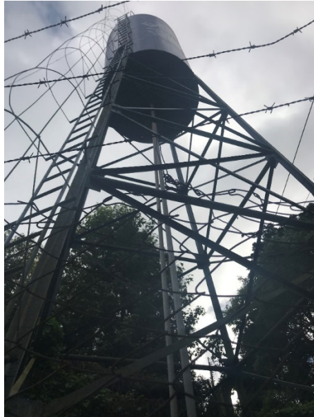
Figura 24. Tanque de almacenamiento Tanque III
