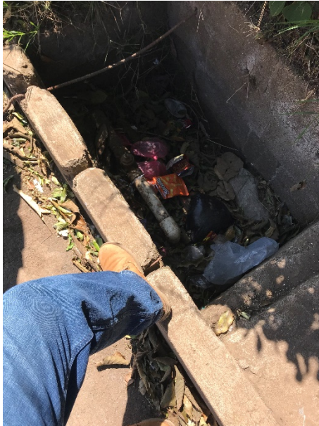
Figura 29. Caja de protección sin tapadera acumulando basura
