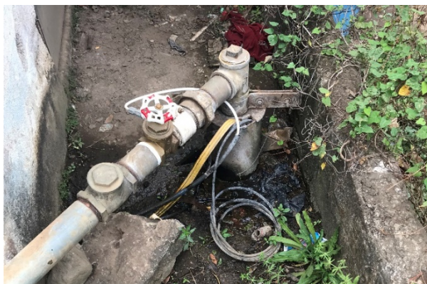
Figura 18. Pozo de agua potable El Jocotillo III
