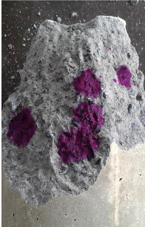
Figura 21. Ensayo de carbonatación en concreto
