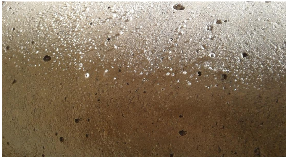
Figura 15. Presencia de eflorescencia en la superficie de los cilindros de concreto elaborados con 2,0 mg/L de cloro residual
