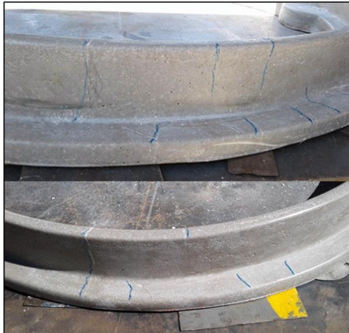
Figura 20. Ejemplo de brocales fallados
