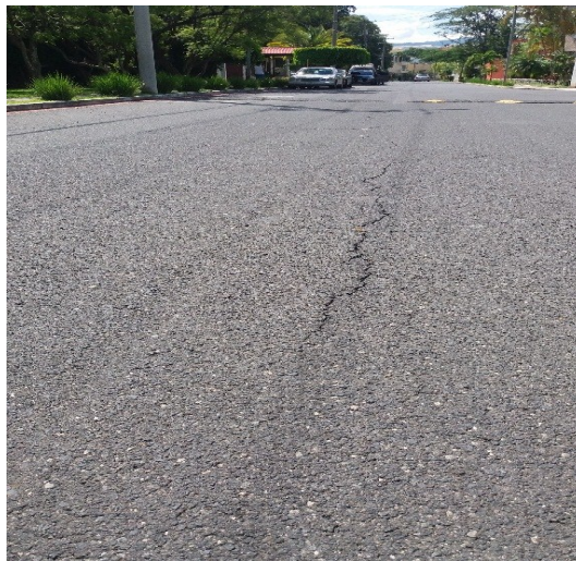
Figura 11. Fotografía de fisura longitudinal
