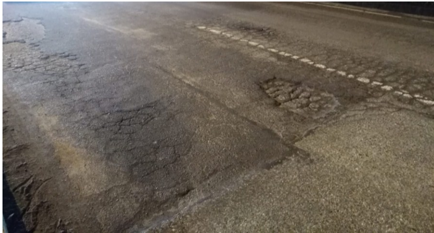
Figura 65. Fotografía de asfalto fatigado
