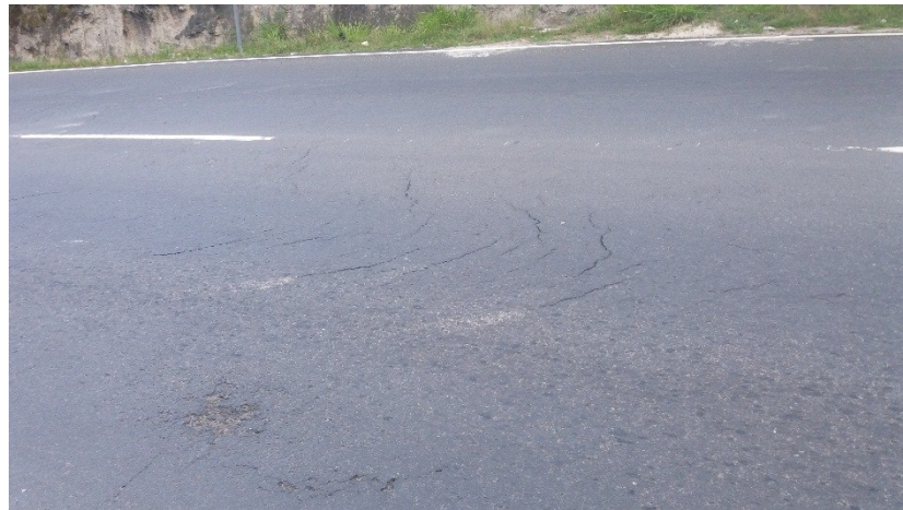
Figura 9. Fotografía de fisuras en arco
