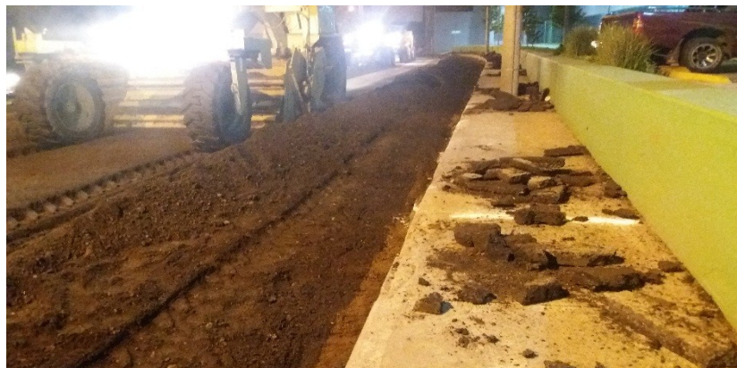
Figura 61. Fotografía de grumos de asfalto
