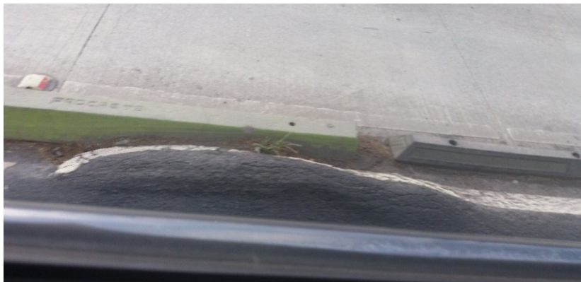
Figura 17. Fotografía de exudación de asfalto
