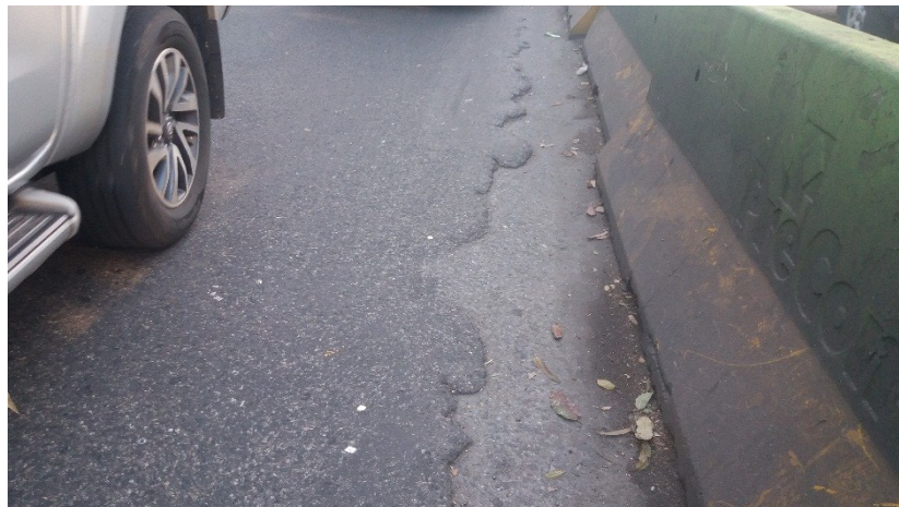
Figura 25. Fotografía de ahuellamiento
