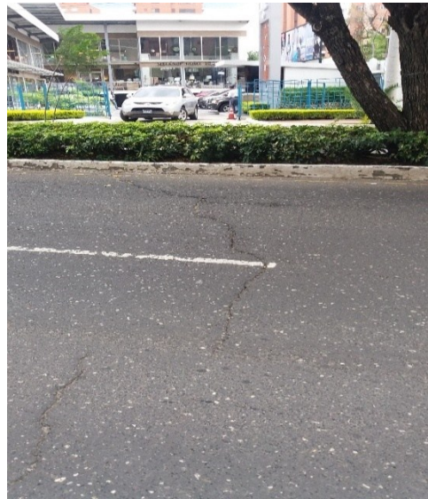
Figura 10. Fotografía de fisura transversal
