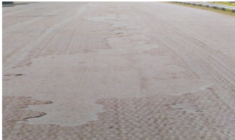
Figura 64. Fotografía de desprendimiento de capas de asfalto
