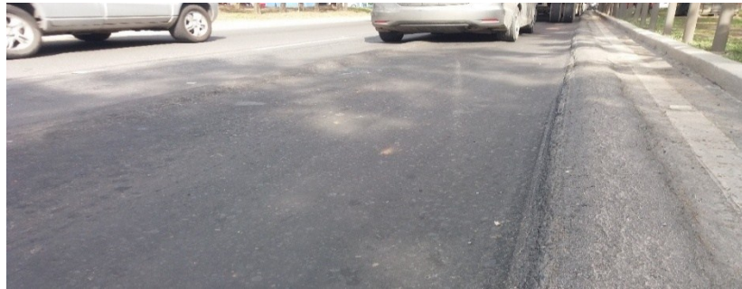
Figura 13. Fotografía de ahuellamiento
