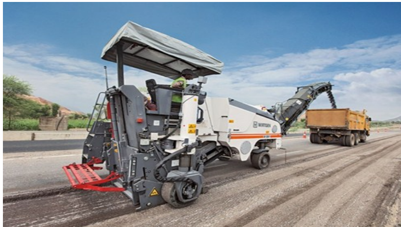
Figura 55. Fotografía de equipo apoyado sobre neumáticos
