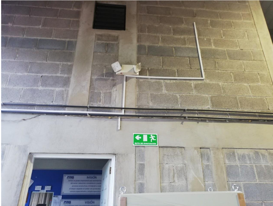
Figura 34. Lámpara de emergencia instalada
