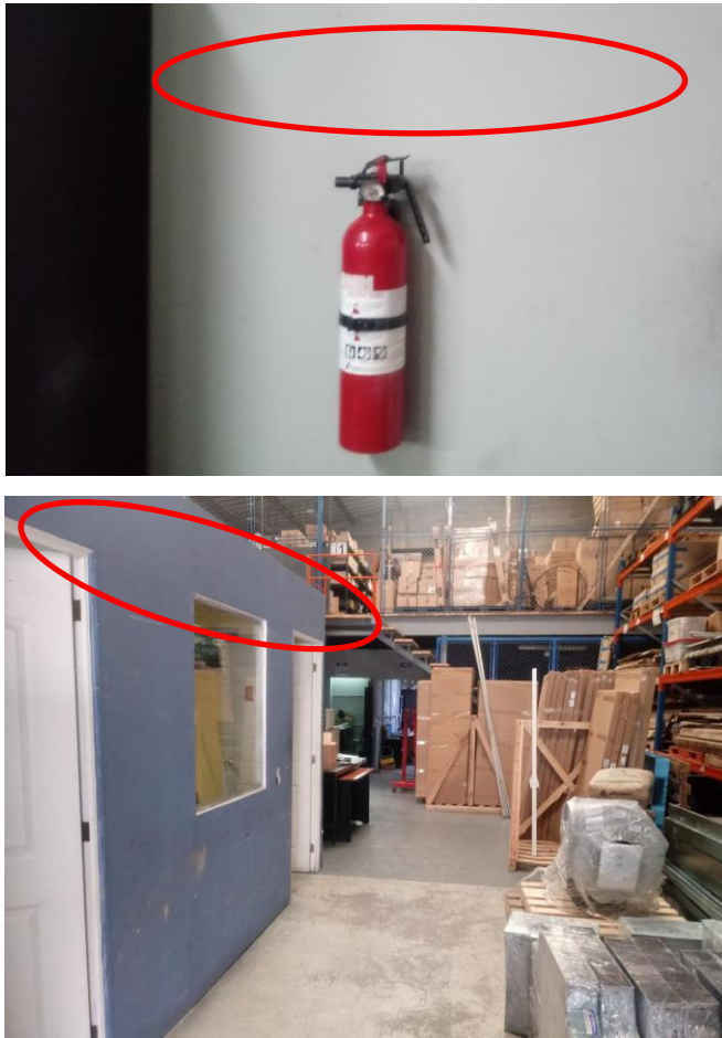
Figura 15. Falta de señalización en las diferentes áreas
