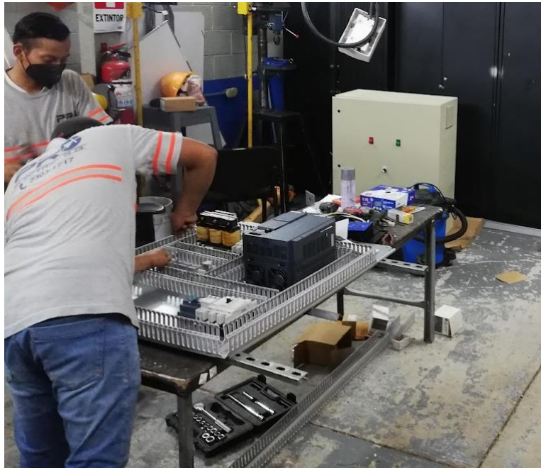
Figura 7. Manipulación de equipos de bajo y medio voltaje
