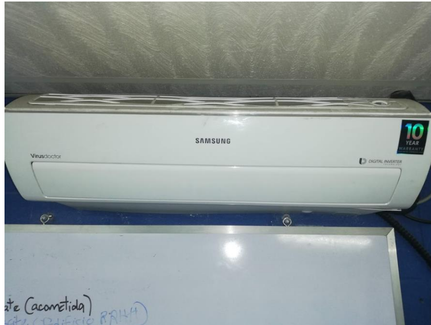
Figura 33. Sistema de aire acondicionado del área de Taller
