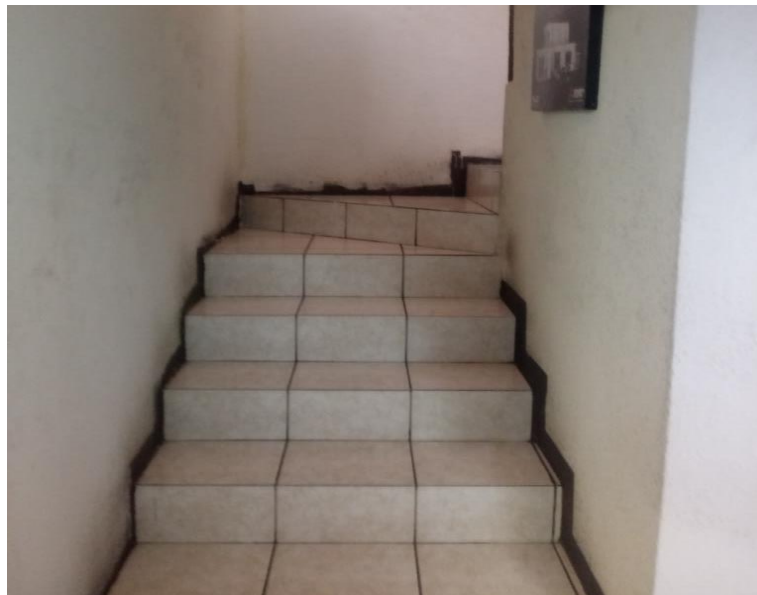
Figura 14. Escaleras principales sin antideslizantes y reflectantes
