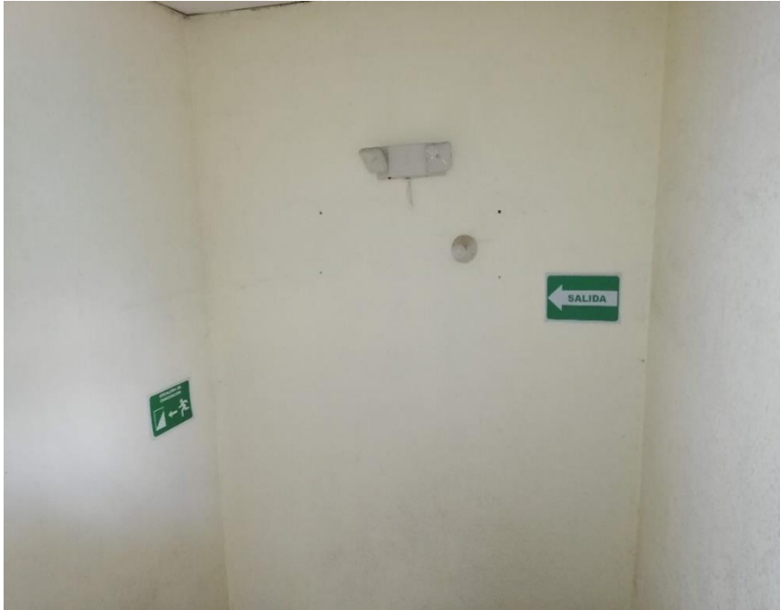
Figura 30. Iluminación de emergencia
