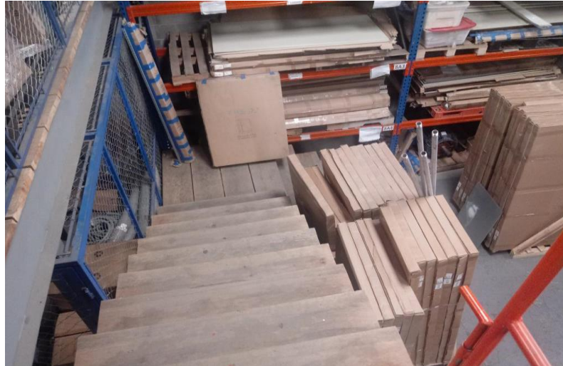
Figura 13. Escalera sin barandilla
