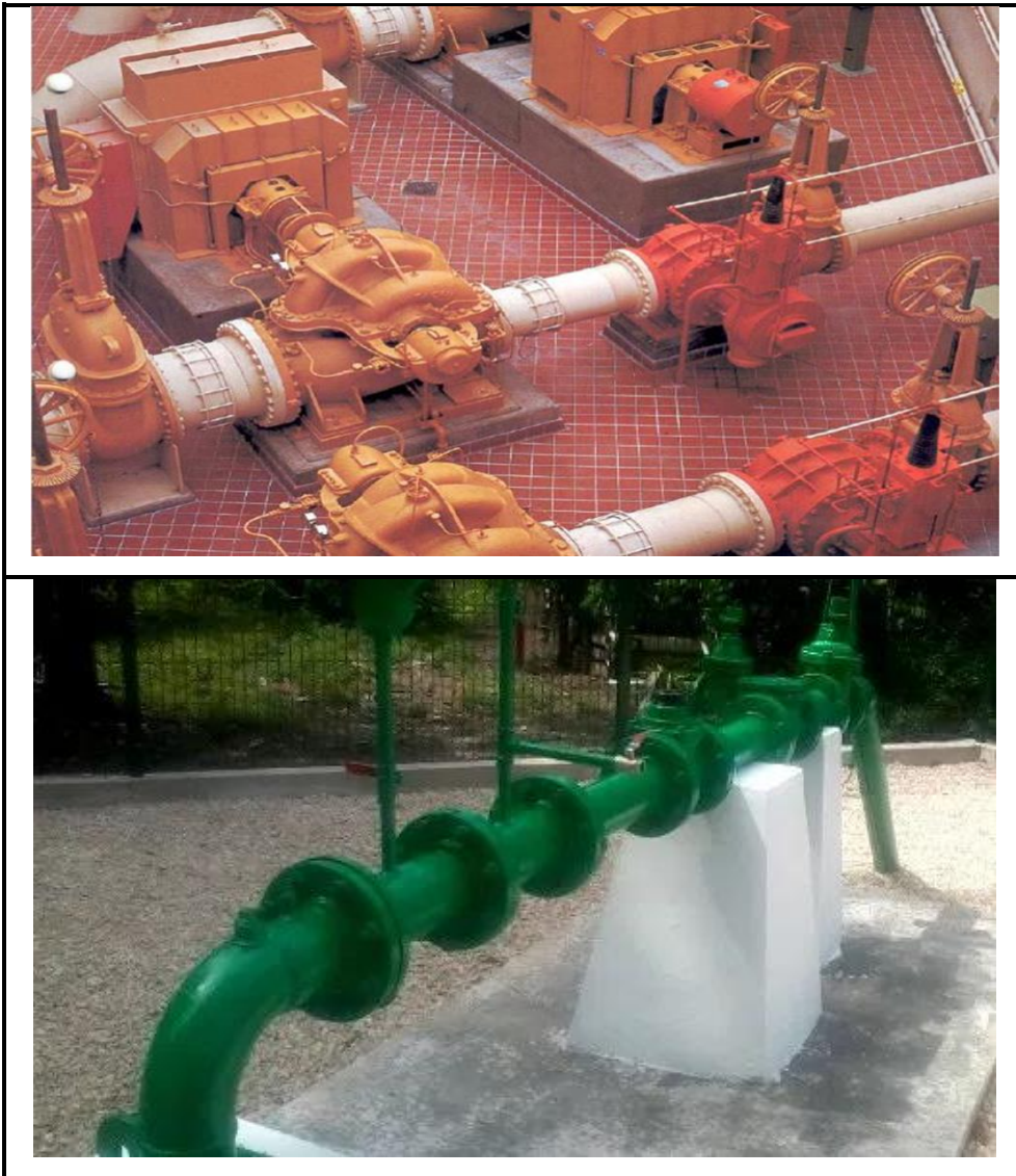
Figura 6. Tuberías sistema de bombeo
