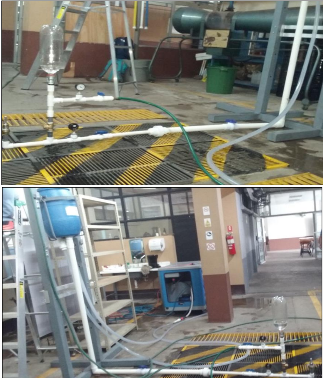
Figura 26. Sistema de bombeo instalado
