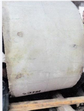
Imagen No. 4 – Fisuras en la parte exterior del tubo
