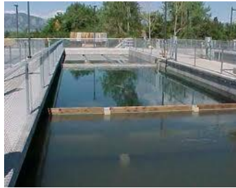
Figura 6. Tanque de floculación
