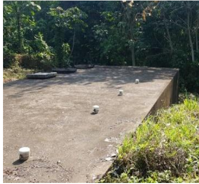
Figura 37. PTAR, caserío Las Cruces
