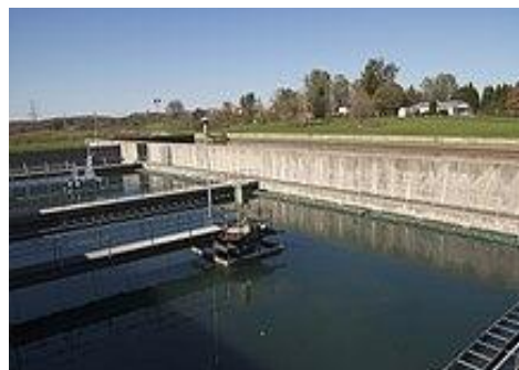
Figura 5. Tanque de coagulación
