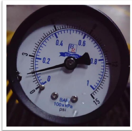
Figura 15. Dato tomado a una (altura del tanque 1,05 m)
