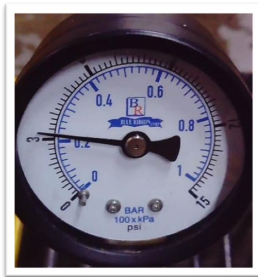
Figura 24. Dato tomado a una (altura del tanque 2,50 m)
