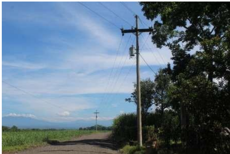
Figura 9. Alumbrado eléctrico aldea Xayá
