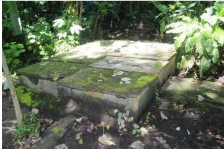
Figura 7. Caja de captación del río Agua Zarca
