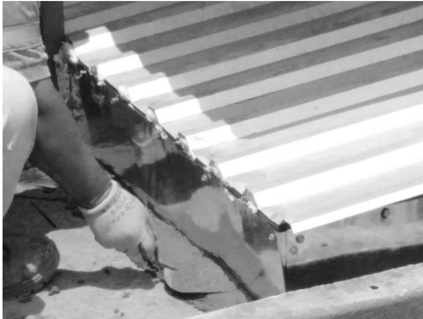
Figura 60. Corrección de deficiencia: sellado de espacio abierto
