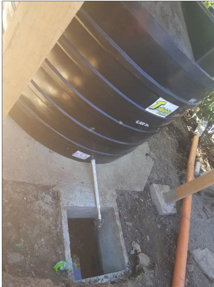
Figura 21. Tanques de captación
