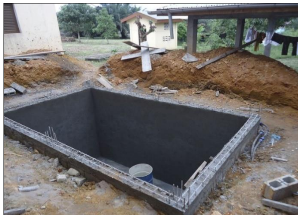
Figura 12. Aljibes para almacenamiento de agua de lluvia
