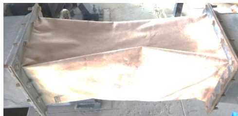
Figura 8. Canal de paso para material procesado
