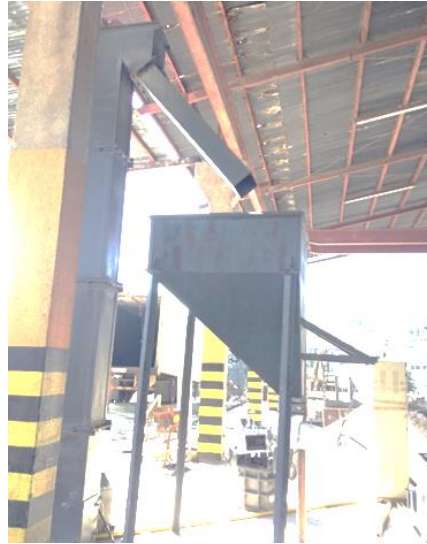
Figura 3. Elevador y deposito
