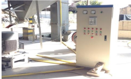
Figura 11. Caja de controles
