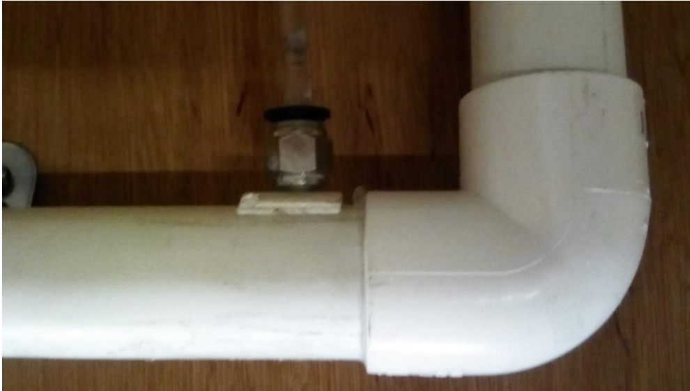
Figura 26. Conexión de la toma de presión en una contracción
